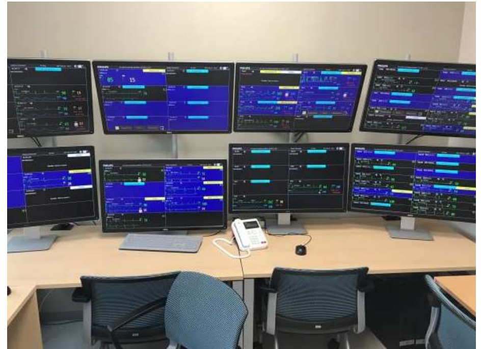
[그림] 중환자실에 설치된 모니터링실
